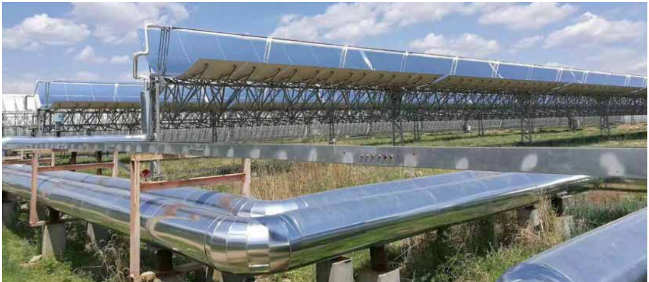
图：我国首个 1MW 槽式光热发电系统 (图片来源：中科院电工所)
