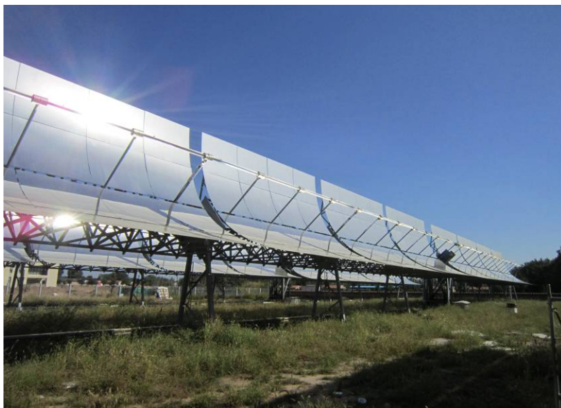
图 3-10 华电工程公司的槽式系统
