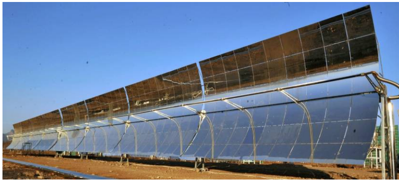
图 3-9 中科院电工所的槽式集热系统
