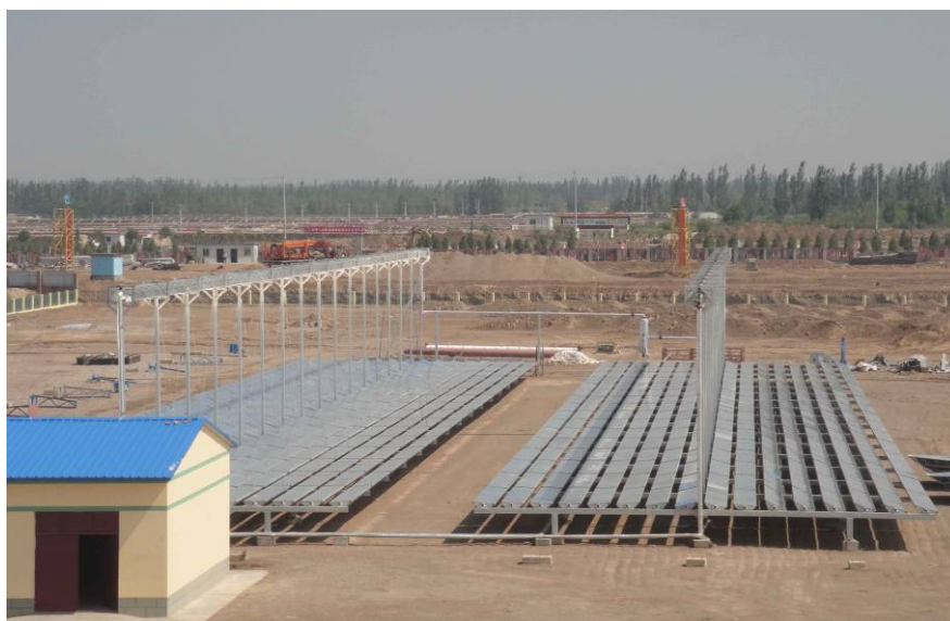
图 3-4 兰州大成科技 160kW 电站
