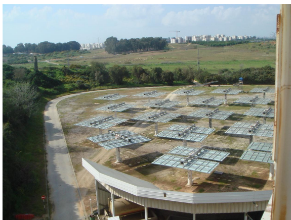
BEAM DOWN 系统定日镜场
