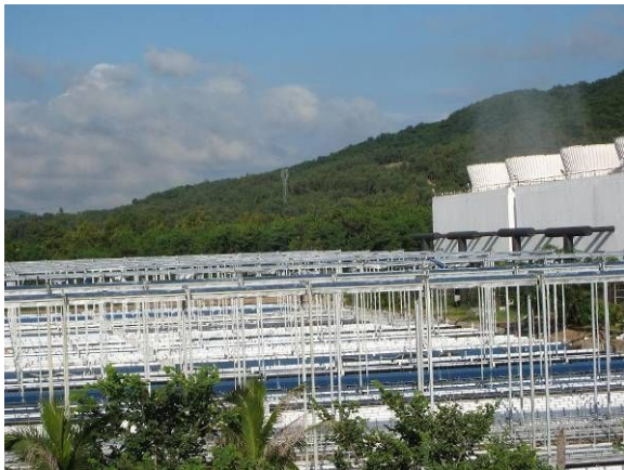
南山电厂太阳能热发电集热场全景
