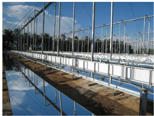
太阳能热发电集热场近景
