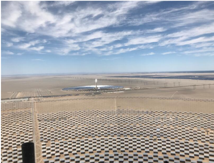
图：首航节能 100MW 电站定日镜场一角，远处为 10MW 塔式电站
