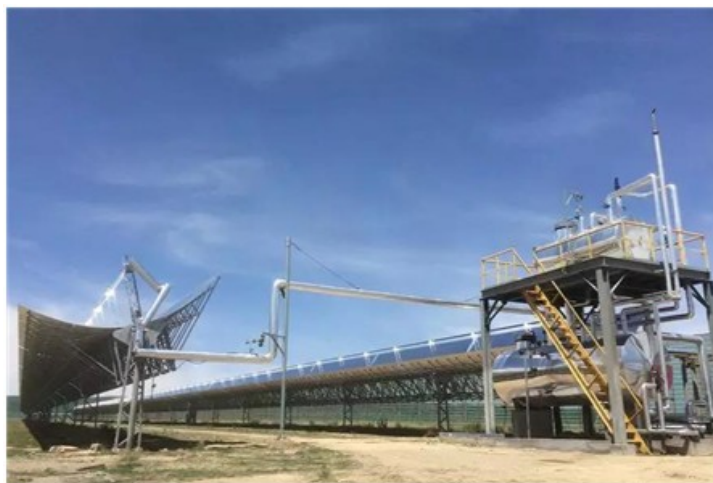
图：龙腾光热内蒙古硅油槽式示范回路
