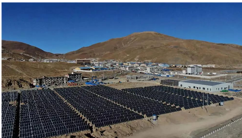
图：西藏日喀则市萨嘎县的太阳能集中供暖工程
