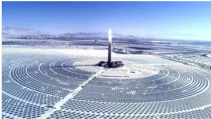
青海中控德令哈 7 小时储能 50MW 光热电站
