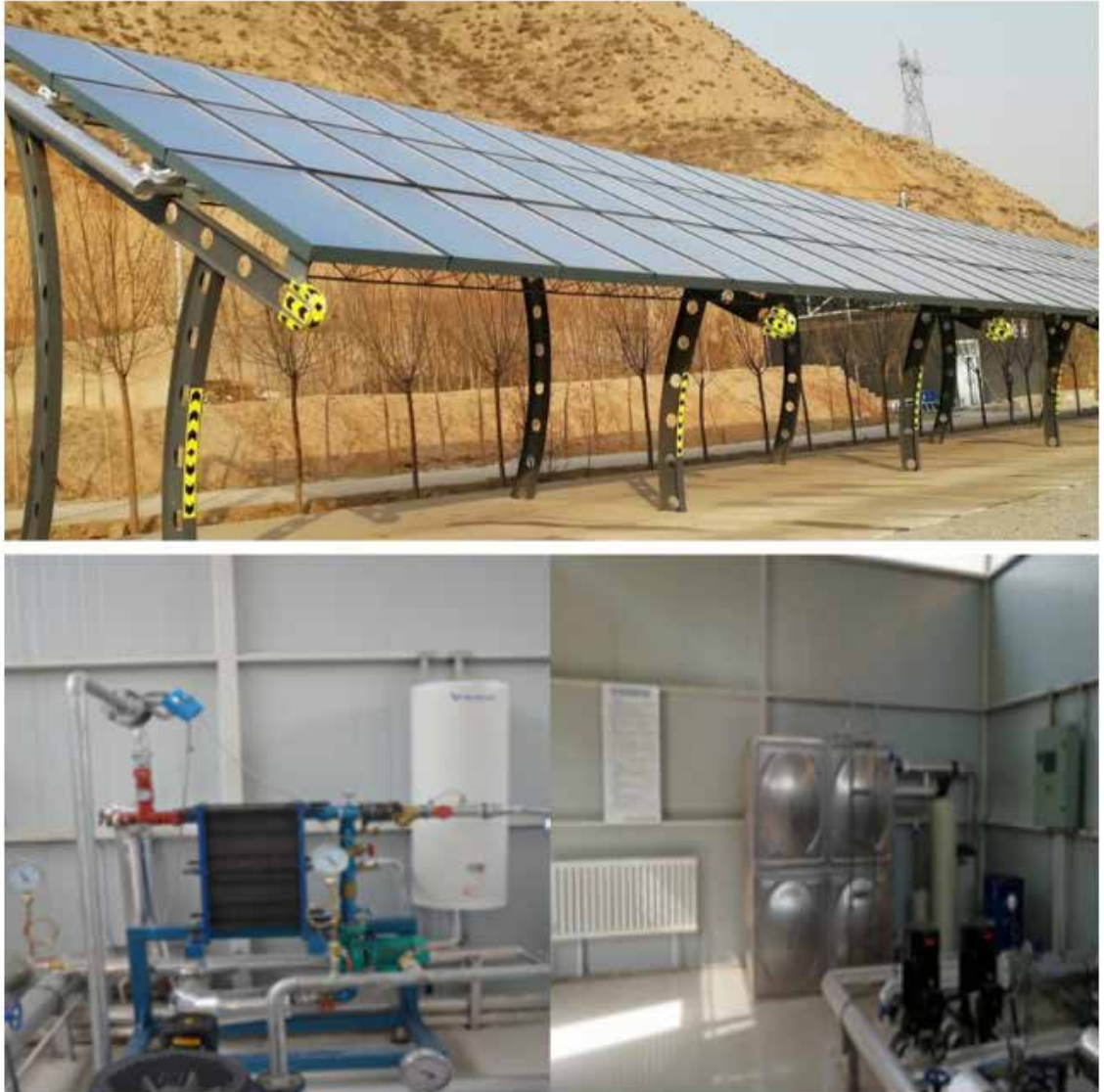
图 6-2-11 太阳能 + 地热能互补供热试点工程实景
