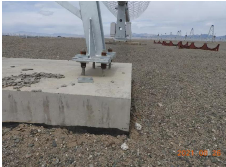
图：项目受地震影响现场
