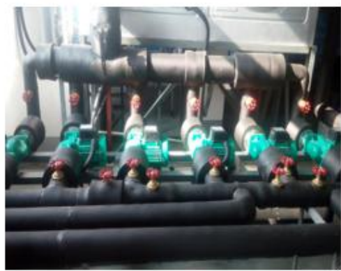
泵房现场照片
