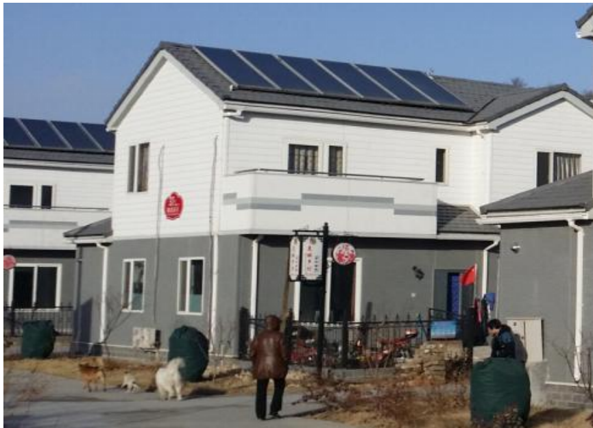
图4 密云石城镇太阳能供热采暖系统实景
