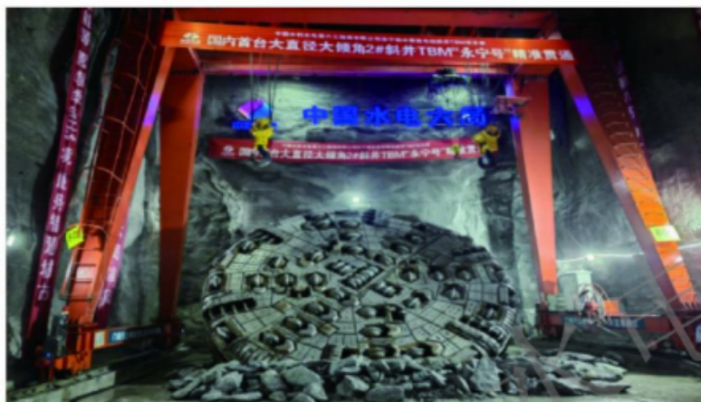
大直径大倾角TBM
