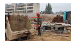
电焊作业未佩戴防护面罩
