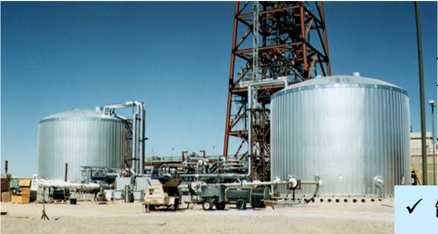
Solar two 实验电站储热罐
