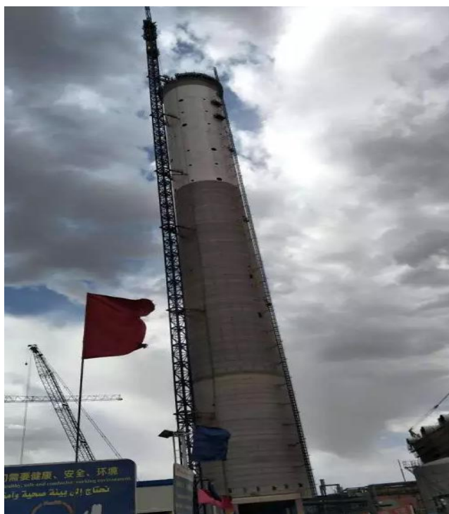
圖：摩洛哥努奧三期塔式太陽能熱發電項目吸熱塔
