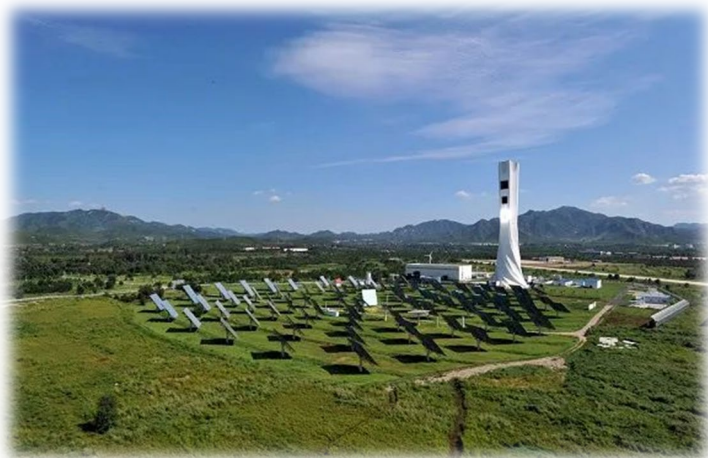
中科院八达岭1兆瓦太阳能塔式热发电项目
